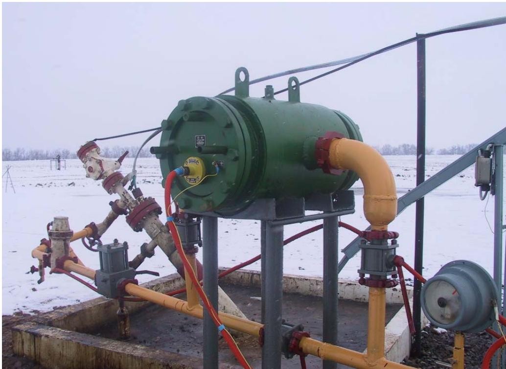
Рисунок 3 - Счетчик СКЖ-120-40М на устье скважины
